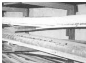
Силовой кабель с покрытием МПВО (2-ая полка сверху) после 5-ти лет эксплуатации
